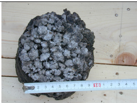
Obr. 6.9 Příklad keramzit betonu degradovaného ettringitem (světle šedé povlaky)
